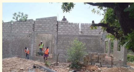
Das Augenzentrum von Zorgho in Burkina Faso bekämpft Blindheit durch Beratungen, Untersuchungen, Brillenversorgung und vor allem Augenoperationen. Aufgrund prekärer Unterbringungsmöglichkeiten unterstützt der FKW mit dem Bau eines neuen Gebäudes.
